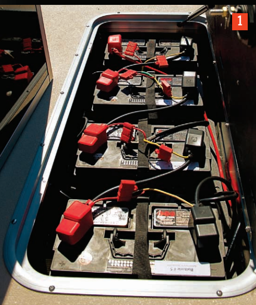
1 – Groupe d'alimentation complet de quatre batteries
